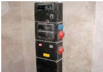
Elektrant in einer Rettungsnische
