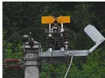
Erdungsschalter Stellung „geerdet“
