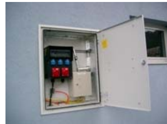
Einbaukasten am Technikgebäude
