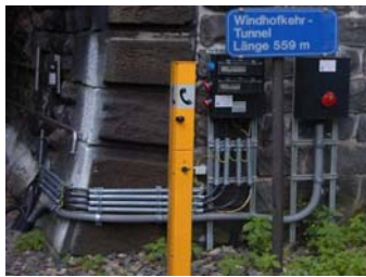
Notruffernsprecher am Portal
